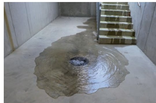
FLUTUNG DURCH DIE KANALISATION.
