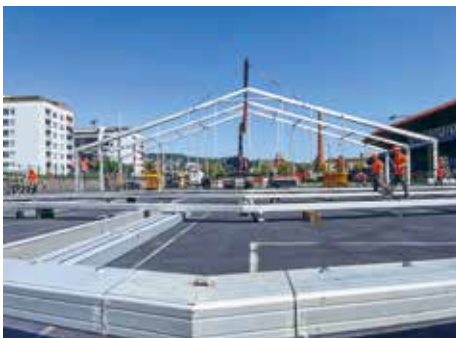
Prima: vengono montate le fondamenta e le impalcature per le tende VIP nell'area esterna.
